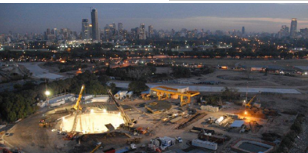
Cantiere della ditta Ghella a Canale Maldonado, Buenos Aires (Argentina). Foto per cortesia della ditta Ghella.
